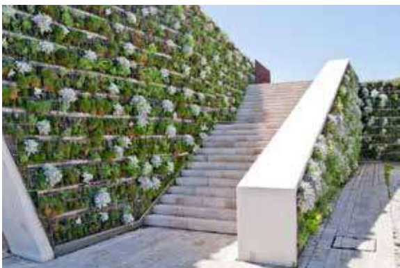
Alimentation de murs végétaux
